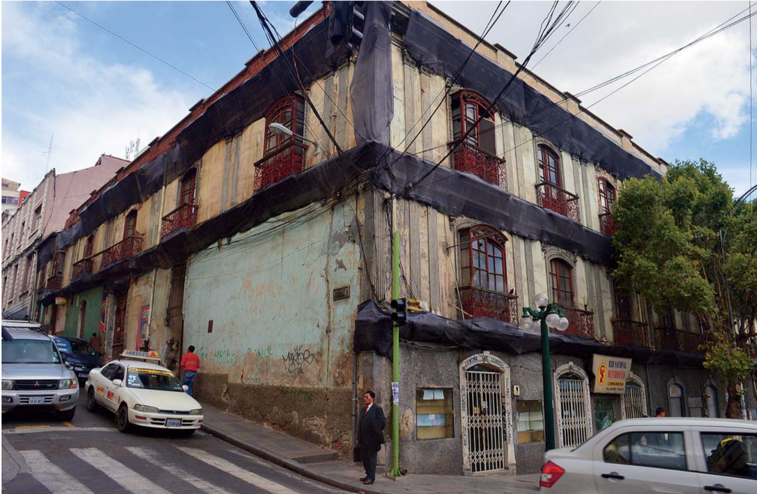
LAS ANTIGUAS EDIFICACIONES CONOCIDAS COMO "CASAS PATRIMONIALES" ESTÁN A PUNTO DE SUFRIR DERRUMBES DEBIDO A LOS EFECTOS DE LA PERSISTENTE LLUVIA. LAS EXCAVACIONES Y LAS VIBRACIONES DE LA MAQUINARIA PESADA REPRESENTAN UN PELIGRO PARA ESTAS.
