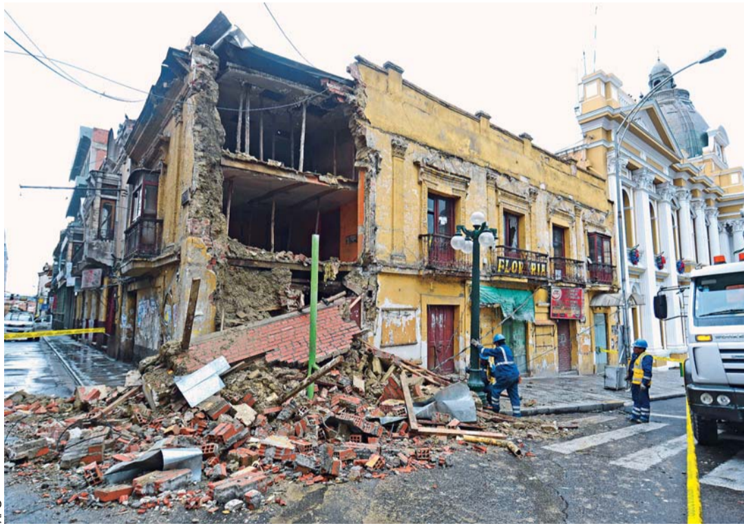
LA LLUVIA CAÍDA DESDE EL SÁBADO HASTA LA MADRUGADA DEL DOMINGO PROVOCÓ EL DERRUMBE DEL MURO DE UNA CASA PATRIMONIAL UBICADA EN PLAZA MURILLO.
