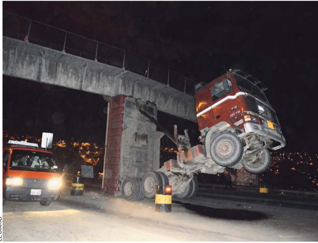
CAMIÓN DAÑO PELIGROSAMENTE LA ESTRUCTURA DE UNA PASARELA DE LA AUTOPISTA LA PAZ- EL ALTO.
