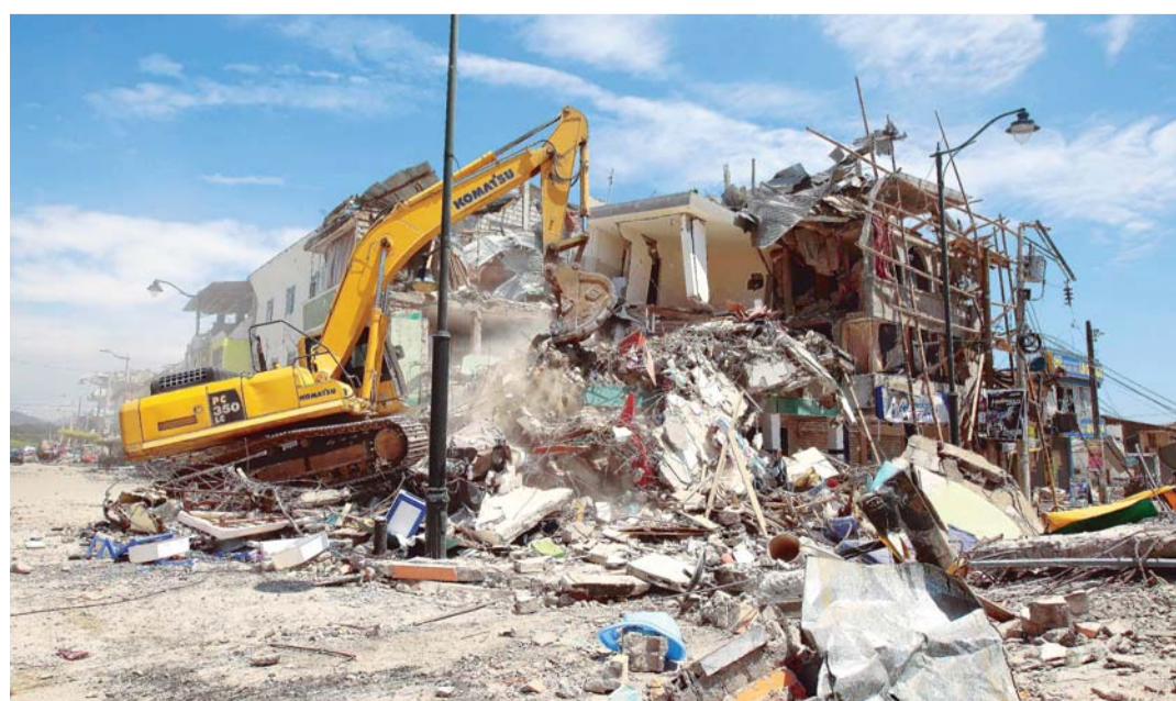
DESTRUCCIÓN DE CIENTOS DE EDIFICIOS EN ECUADOR.
