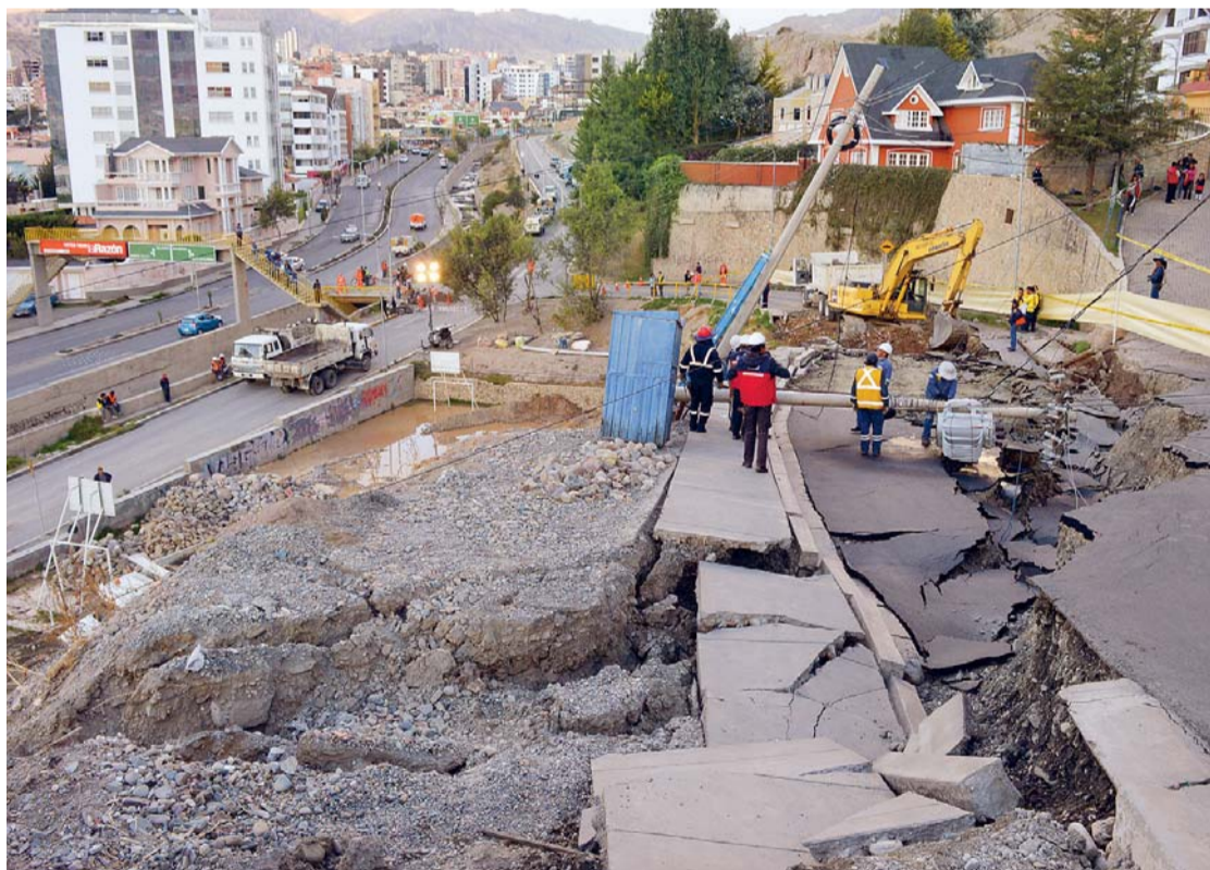
LA PLATAFORMA DE LA AVENIDA LOS ÁLAMOS, EN EL SECTOR DE INGRESO AL BARRIO ALTO LA FLORIDA, SE DESLIZÓ 40 METROS.
