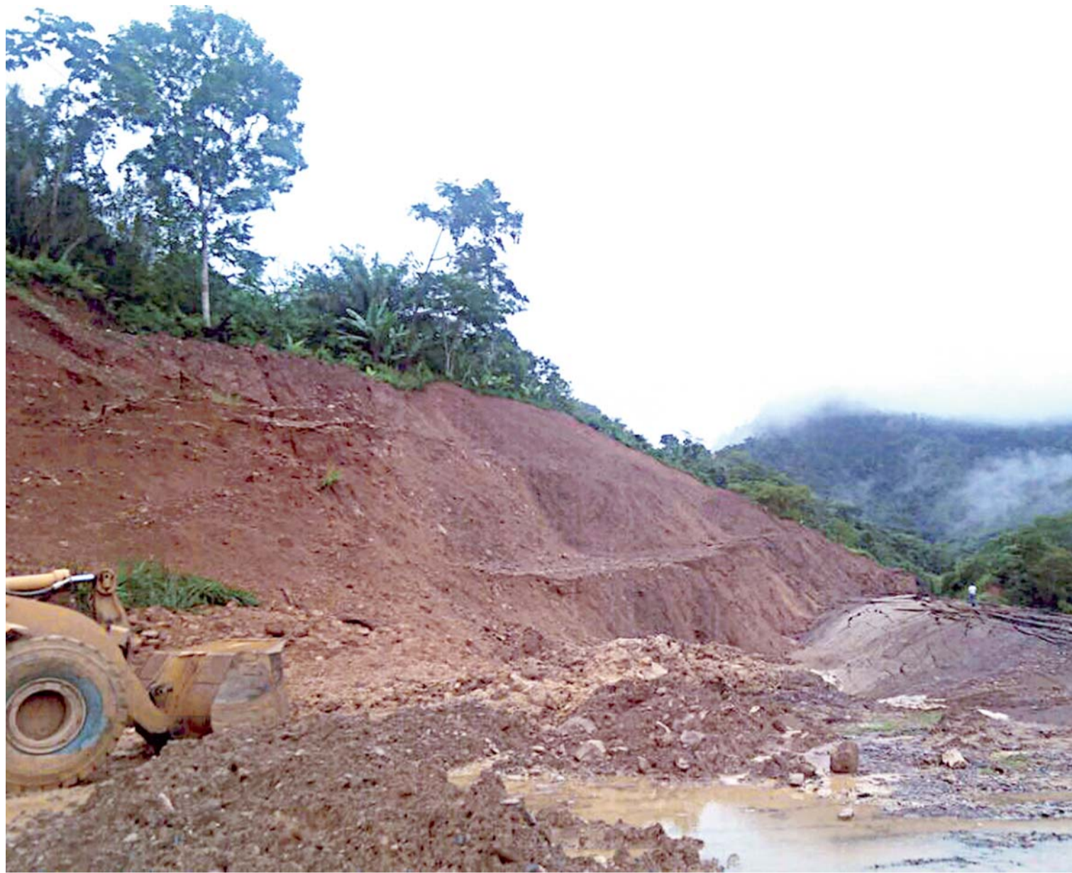
CAMINO OBSTRUIDO A CAUSA DE UN DESLIZAMIENTO DE PLATAFORMA EN CARANAVI, A LA ALTURA DEL KILÓMETRO 11.
