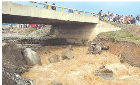
PUENTE CUCUTA EN PELIGRO DE CEDER ANTE CAUDAL DE RÍO.
