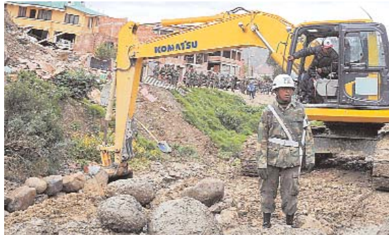
ALCALDÍA COMENZÓ AYER LA REMOCIÓN DE ESCOMBROS EN LA ZONA AFECTADA.
