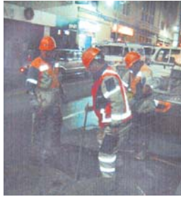
RUPTURA DE TUBERÍA PROVOCÓ CAOS EN CENTRO DE LA CIUDAD.
