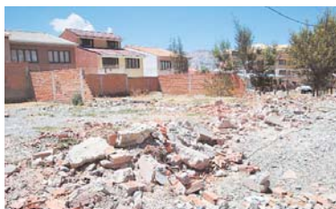
VECINOS EXIGEN LA REPOSICIÓN DE PAREDES Y RESTITUCIÓN DE TERRENOS AFECTADOS POR EL DESVÍO DEL RÍO.
