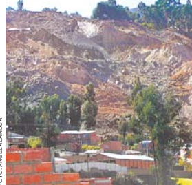
EL DESLIZAMIENTO NO COBRÓ VÍCTIMAS FATALES, PERO SI CUANTIOSAS PÉRDIDAS MATERIALES.
