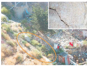
EL EMBOVEDADO DE RECIENTE INAUGURACIÓN YA PRESENTA DEFICIENCIAS.
